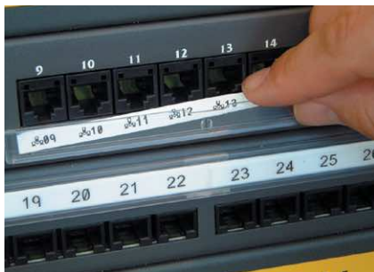
Étiquettes pour baies de brassage et panneaux de connexion
